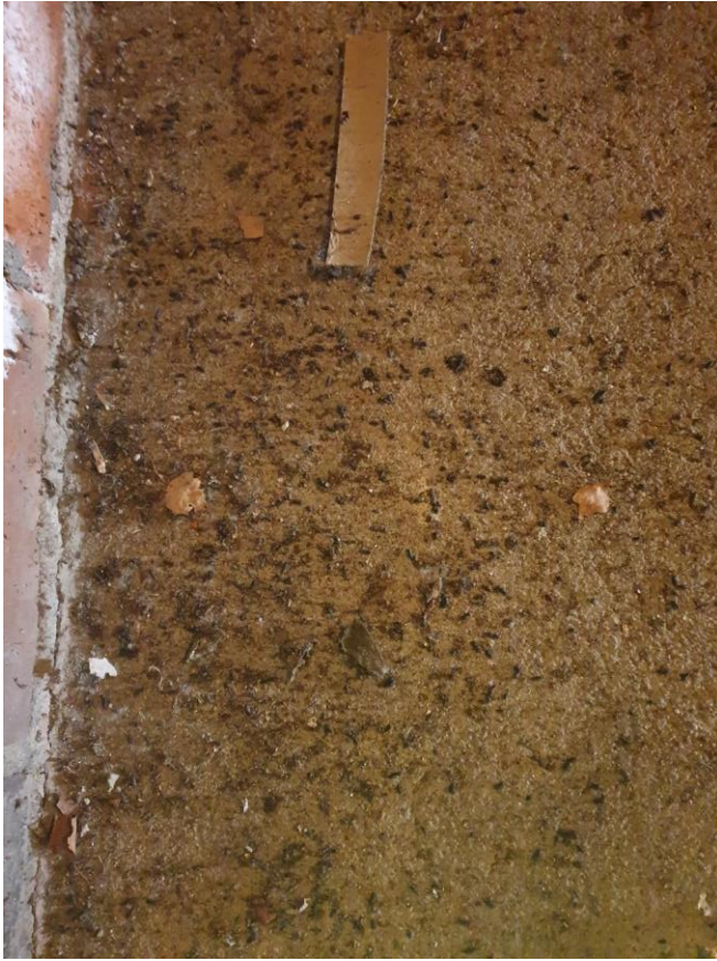
Kuva 10. Papanoita lattialla muurin vieressä rakennuksessa B.
