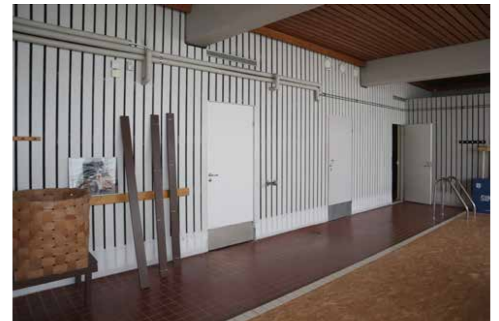
Uima-allas on vaurioitunut ja pois käytössä. Allas on levytetty umpeen.
