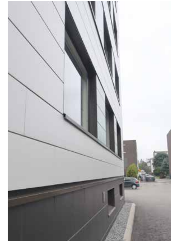
Alkujaan pesubetonipintainen sokkeli ja betonipintainen julkisivu on korvattu keraamisella laattaverhoilulla. Lisälämmöneristys näkyy syventyneinä ikkunasmyygeinä.
