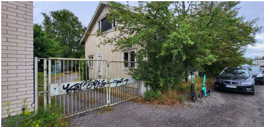
1952 valmistunut teollisuusalueen puolella sijaitseva puutalo osoitteessa Ilmarisen-tie 4 on huonossa kunnossa.
