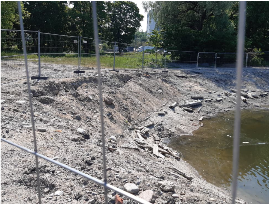
Kuva 6. Hulevesialtaan luiskassa on erotettavissa eri maakerrokset
