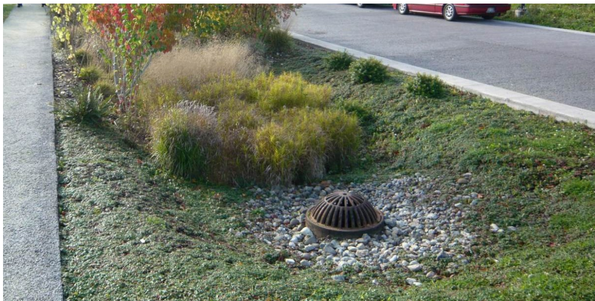
Kuva 20. Kadun vieressä sijaitseva viherpainanne ja nostettu ylivuotoritiläkansi 11 .
