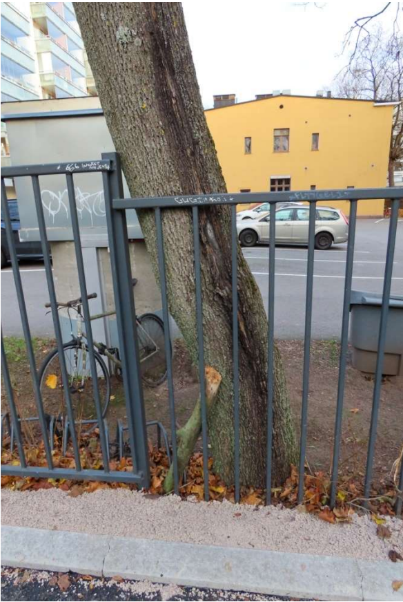
Kuva 10. Vaahtera 4 rungossa oleva halkeama. Runko kasvaa kiinni aitaan.
