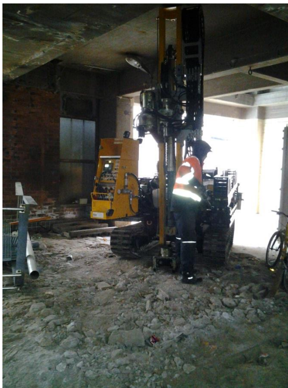
Kuva 1: Tutkimuspisteen S1 kairaus. Alueella betonilaatan pinta oli rikkoutunut ja maan joukossa oli nähtävissä mm. tiilijätettä.
