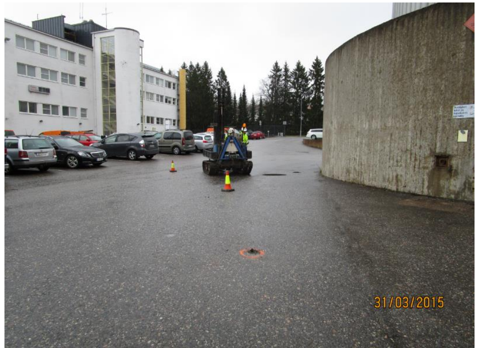
Kuva 5. Näytteenotto tutkimuspisteessä S17. Kuvassa vasemmalla käyttökeskusrakennus ja oikealla 1970-luvulla rakennettu öljysäiliö. Etualalla tutkimuspiste S16.
