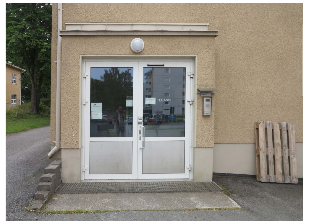
2008 rakennetun porrashuoneen uudet yksityiskohdat erottuvat muutoksena. Alumiini-rakenteisen oven ja alumiini-ikkunoiden mittasuhteet ja materiaalin vaikutelma on alkuperäisestä selvästi poikkeava kuten myös räystään yksityiskohdat.
