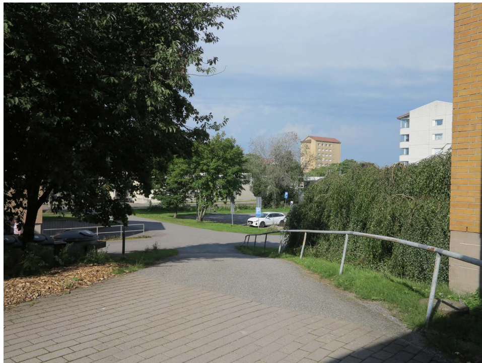
Näkymä Kurjenmäkikoti 2 sisäänkäynniltä Kurjenmäenkadun suuntaan. Ruostunut kallellaan oleva käsijohde tien reunassa luo epäsiistiä vaikutelmaa..
