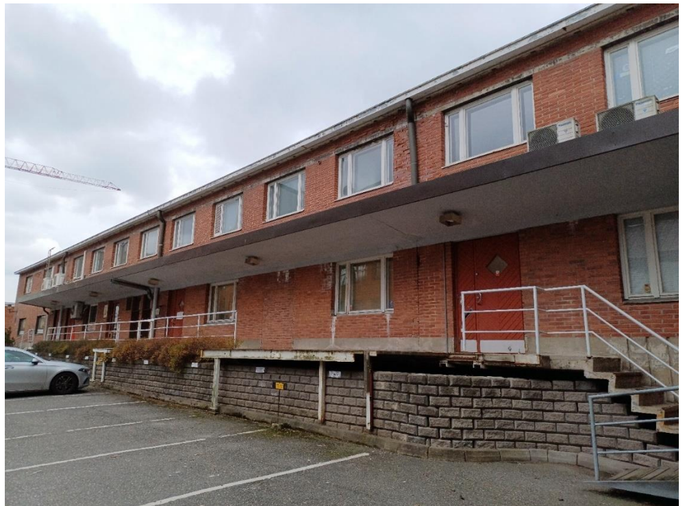
Kuva 105 Rakennuksen Läntisen Pitkätien suuntaisen julkisivu sisäpihan puolella. Seinien tiilipinta on vaurioitunut räystäsvoutojen takia.
