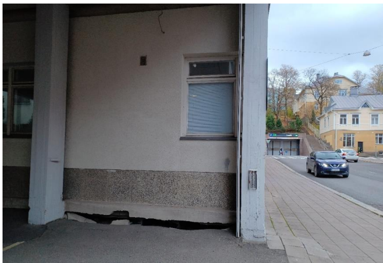
Kuva 100 Maa on routunut ja pettänyt perustusten vieressä Ajurinkadun puolella.
