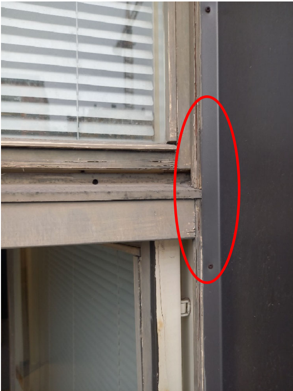
Kuva 15. Ikkunoiden smyygipellityksiä ei ole tiivistetty, sadevesi voi päästä puukarmin ja ulkoseinän väliin.
