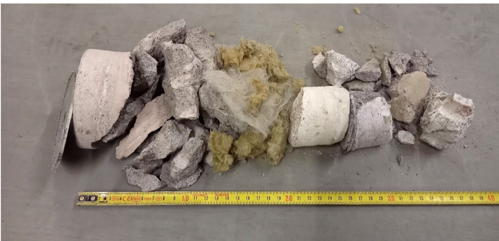
Kuva 20. IV-konehuoneen välipohjarakenne on tehty vanhan yläpohjan päälle. Rakenne on monikerroksinen ja sisältää herkästi mikrobivaurioituvaa materiaalia sekä todennäköisesti haitta-aineita.
