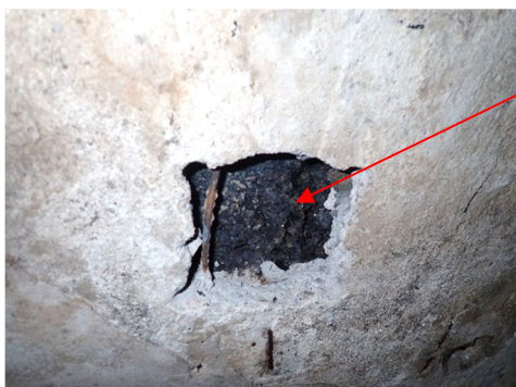
Kuva 17. Ensimmäisen kerroksen ja kellarikerroksen välipohjarakenne. Rakenteeseen on jätetty muottilaudoitusta, jossa on todennäköisesti mikrobikasvustoa. Alalaatan päällä on bitumisively ja korkkieriste.
