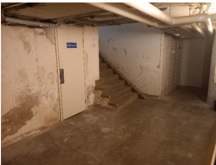
Kuva 2. Kellaritilat ovat aistinvaraisesti arvioiden huonokuntoisia.
