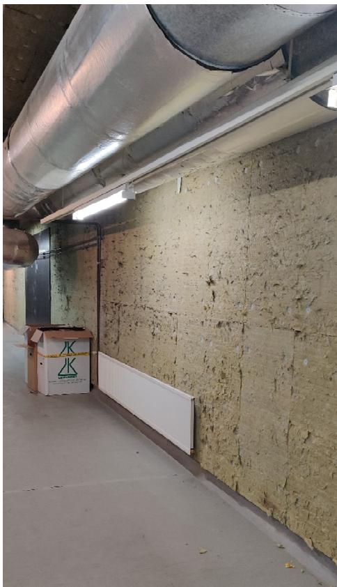
Kuva 13. IV-konehuoneen seinät ja katto on vuorattu pinnoittamattomalla mineraalivillalla, josta irtoaa kuituja.
