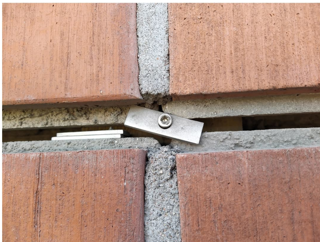
Kuva 9. Yksityiskohta Rati-elementtien saumasta ja kiinnityksestä. Rati-elementin sauma on auennut huomattavan paljon rakennuksen rungon liikkumisesta ja ulkoverhousrakenteen lämpö- ja kosteusliikkeistä johtuen. Taustalla näkyy puinen elementtien kiinnitysalusta, il- meisesti lauta.
