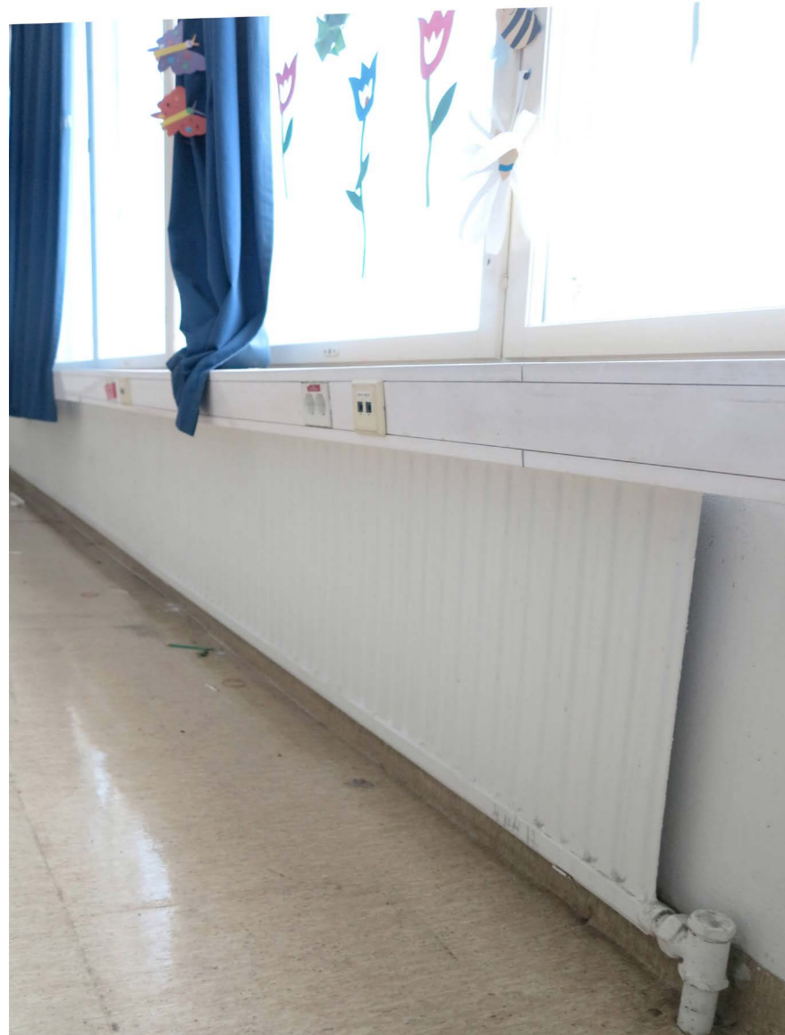
Ulkoseinustalle on lisätty sähköistä, Ohuet levypatterit ovat alkuperäisiä.
