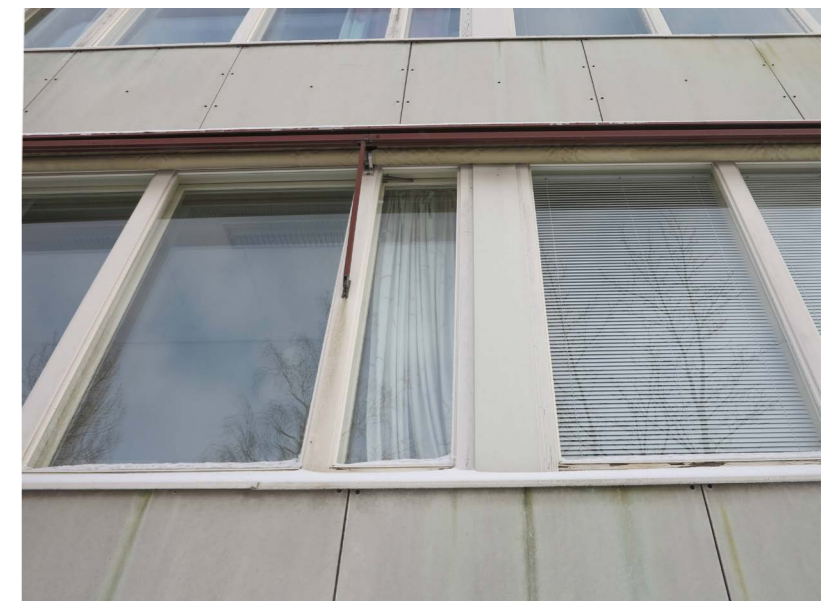
Ikkunoiden yläreunassa on markiisit. Mineritlevyjen maali on haalistunut ja levyt likaantuneet.
