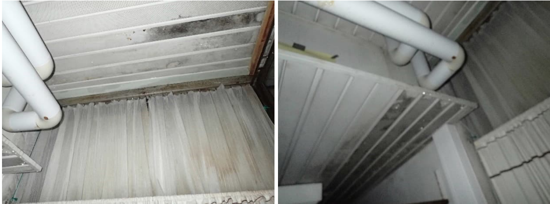
Kuva 27 ja 28. Ensimmäisen kerroksen vahtimestarin tiloihin ja ala-aulaan vuotaa runsaasti vettä välipohjan läpi. Pinnat ja kaikki tilassa olevat tavarat ovat mikrobivaurioituneita.
