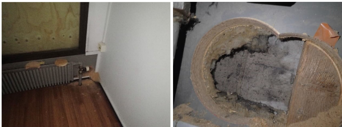
Kuva 36 ja 37. Mikrobimateriaalinäyte N17 otettiin alahallin ulkoseinän eristeestä.
