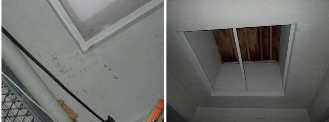
Kuva 23 ja 24. Vesivuotojälkiä havaittiin rikkoutuneiden kattoikkunoiden ja paikatus kattoikkunan kohdalla.
