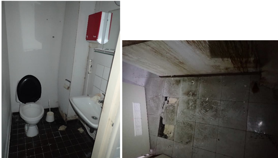
Kuva 25 ja 26. Vaurioitunut kattovesiviemärin kotelointi neljännen kerroksen kaakkoisnurkan wc-tilassa ja toimistohuoneessa.
