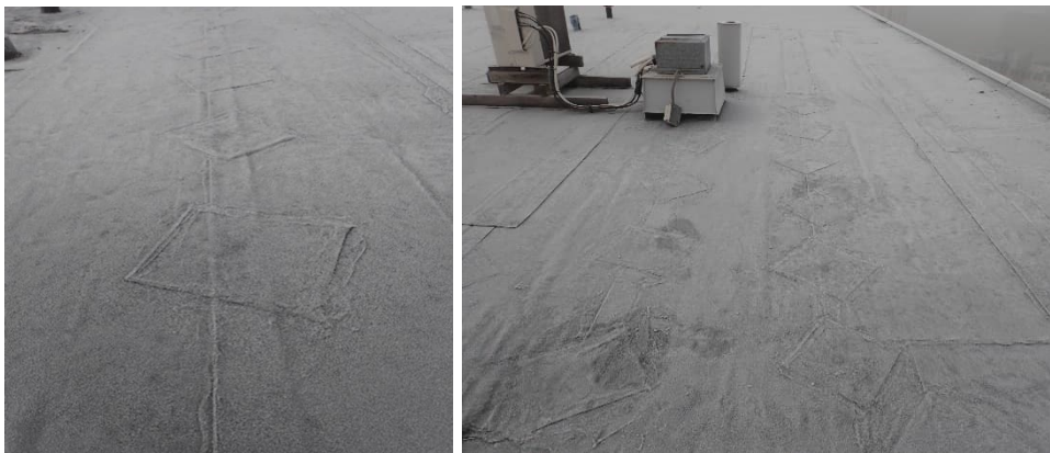
Kuva 13 ja 14. Vesikattoa oli paikattu pienillä kermipaikoilla.
