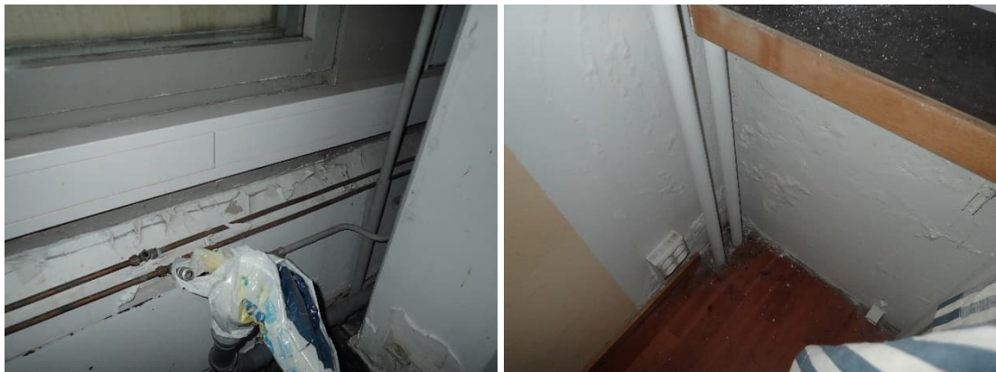
Kuva 32 ja 33. Rikottujen ikkunoiden kohdalla havaittiin kosteusvaurioita ulkoseinissä.
