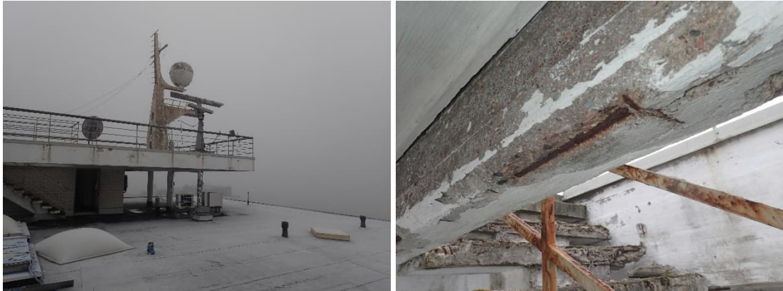
Kuva 9 ja 10. Porraskäytävän päällä olevan betonirakenteisen tasanteen rakenteet olivat hyvin heikkokuntoisia. Portaista oli lohkeillut irti palasia.
