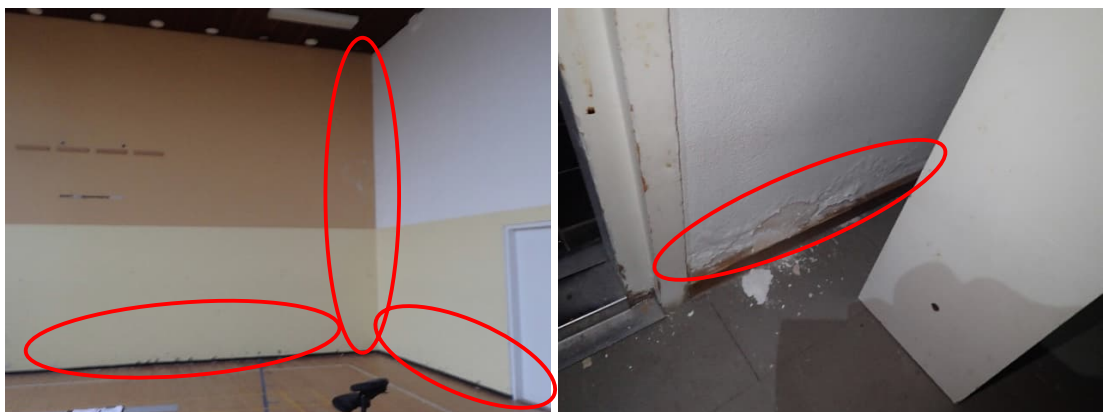
Kuva 42 ja 43. Voimistelusalin väliseinissä oli runsaasti kosteusvaurioita ja rakenteen kosteus oli koholla pintakosteusilmmaisimella tehdyssä kartoituksessa (ympyröity). Seinien alaosien kupruilua kattovesiviemärien vuotoalueella.
