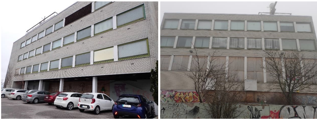
Kuva 1 ja 2. Rakennuksen Malminkadun puolen (kaakkoissivusta) ikkunat ovat pääosin ehjiä (kuva 1), mutta meren puolen (lounaissivu) alimpien kerrosten ikkunat on rikottu ja rikottuneiden ikkunoiden päälle on asennettu vanerilevyjä.
