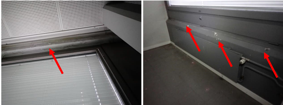
Kuva 30 ja 31. Ulkoseinillä havaittiin tapahtuneen vesivuotoa väli- ja yläpohjien ja ulkoseinien liittymistä sekä ikkunoiden alareunasta.
