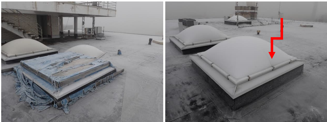
Kuva 17 ja 18. Kattokuvun kohdalle tehty väliaikainen korjaus ei ole enää vesitiivis. Kattokuvuissa oli halkeamia (merkitty punaisella nuolella).
