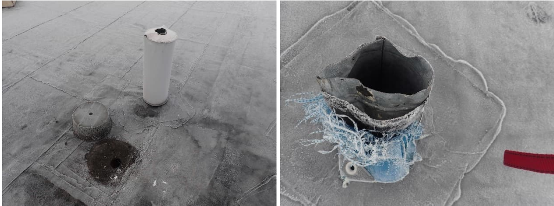
Kuva 15 ja 16. Viemärien tuuletusputket ja ilmanvaihtokanavat olivat epätiivittä. Tuuletusputkien eristeiden pellitykset olivat epätiivittä ja yksittäisen ilmanvaihtokanavan pää oli avoin.
