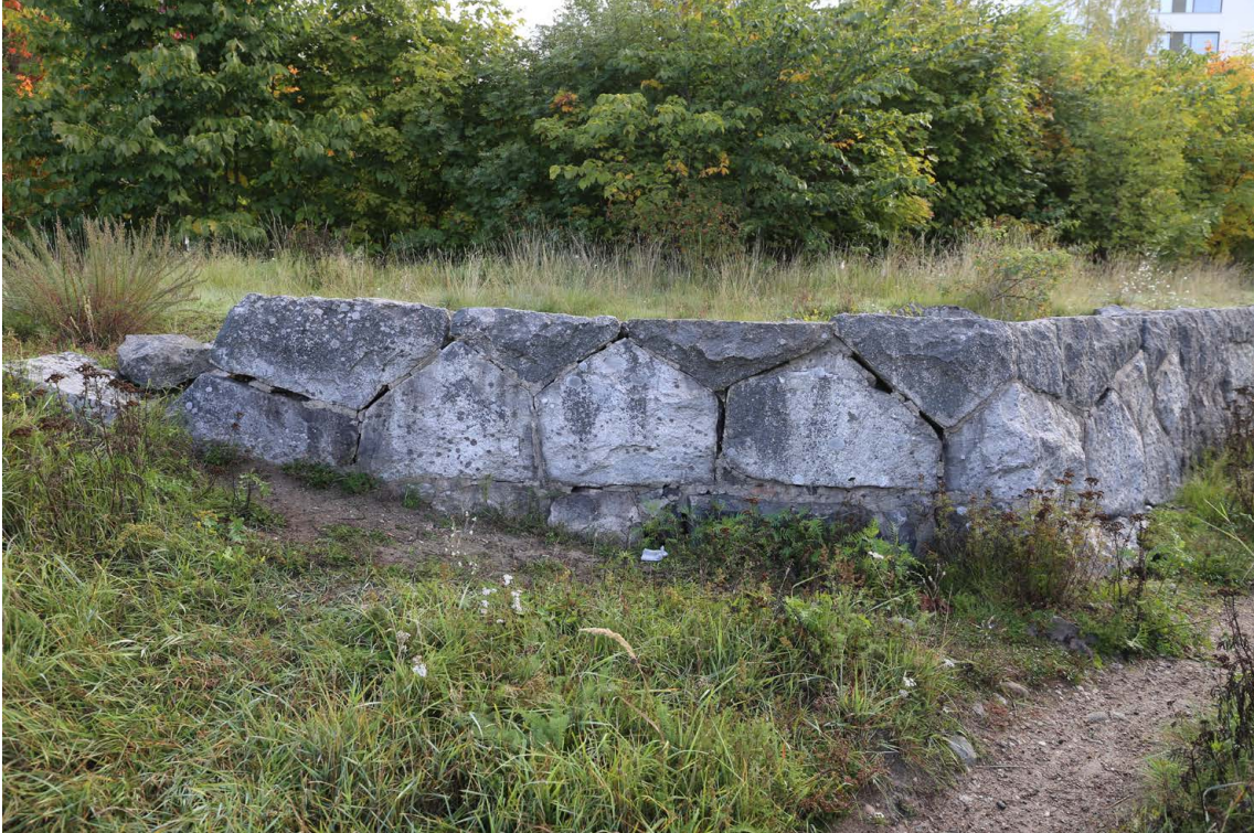
Kuva 11. Muurirakenteen lounaislaidasta on jäljellä vain muutaman metrin pätkä. Vasemmalla muuria on purettu. Lounaasta. 23.9.2022. J. Leppänen. (MuTu122061Dg_8).
