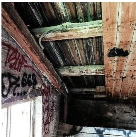
Kuva 8. Kosteus- ja mikrobivaurioita vesikattorakenteessa. CONTRO Oy , 18.12.2020
