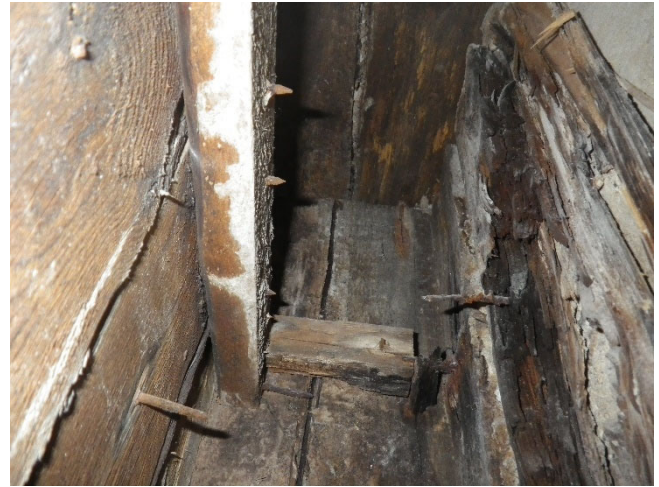
Kuva 2. Ontelotilassa lahonnutta muottilautaa.
