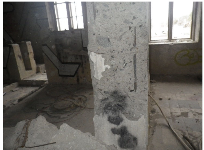
Kuva 4. Pilarin betonipinnassa mekaaninen vaurio.
