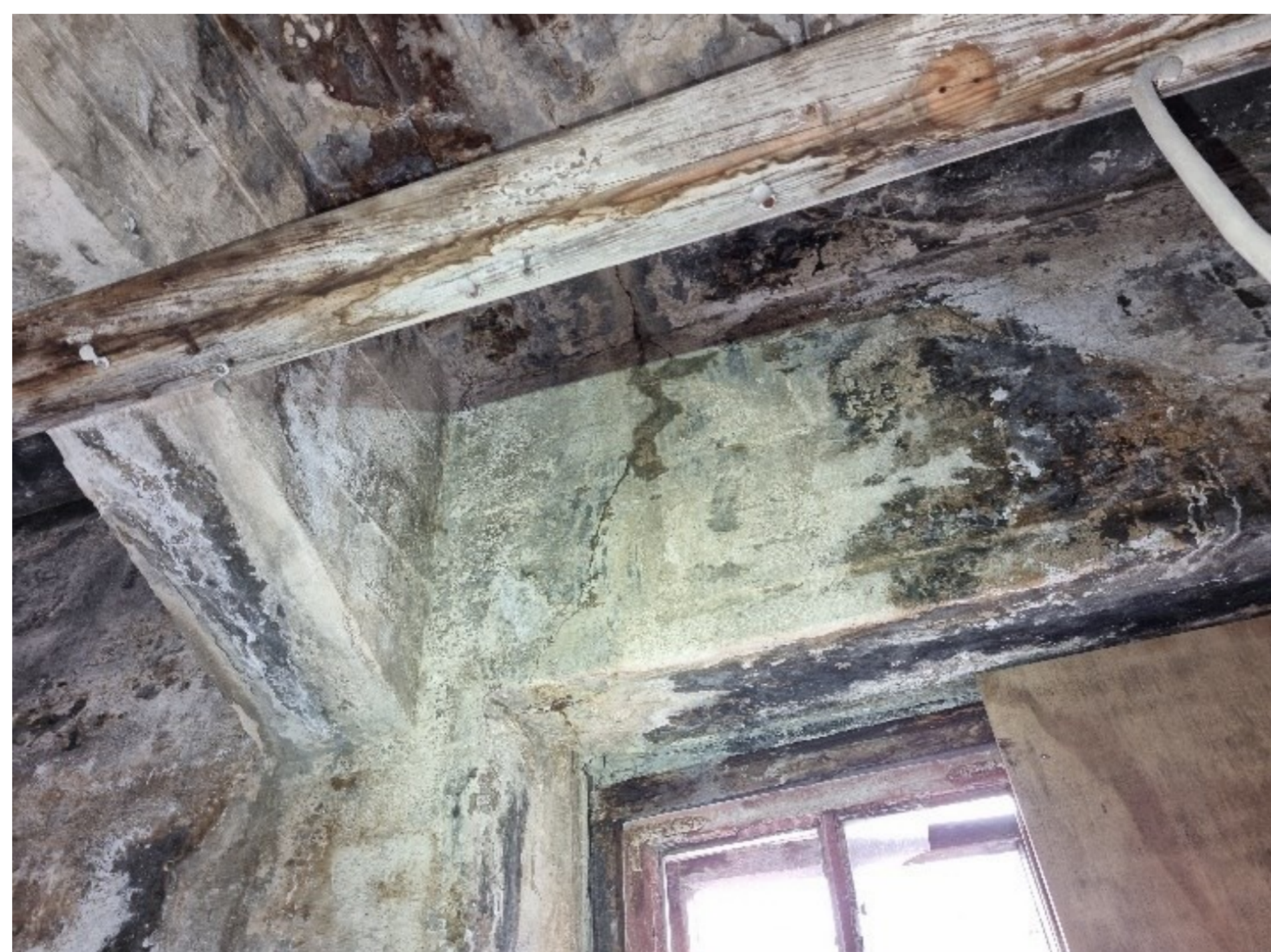
Kuvalainaus kuntoselvityksestä, mikrobivaurioista seinärakennetta
