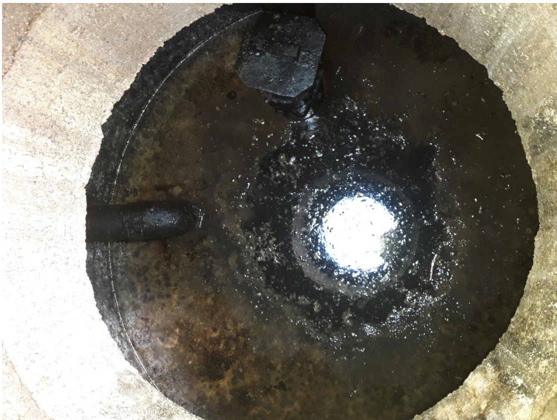
Kuva 2. Näytepisteen P9 vierestä löytyi öljynerotuskaivo, jonka veden pinnalla oli öljykalvo.
