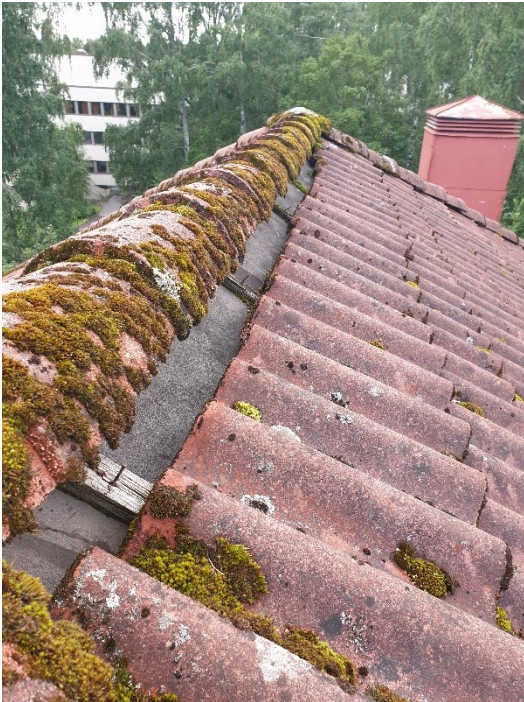
Kuva 2.3. Rakennuksen katto oli huonossa kunnossa, ja lepakoille sopivia kulkureittejä olisi ollut.
