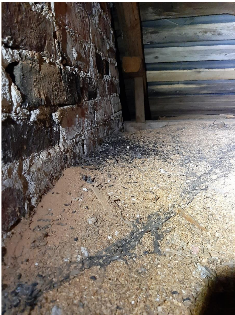
Kuva 3. Lepakoiden ulostetta rakennuksen nro 1 yläpohjassa muurin tyvellä. Kuva: Ville Vasko.
