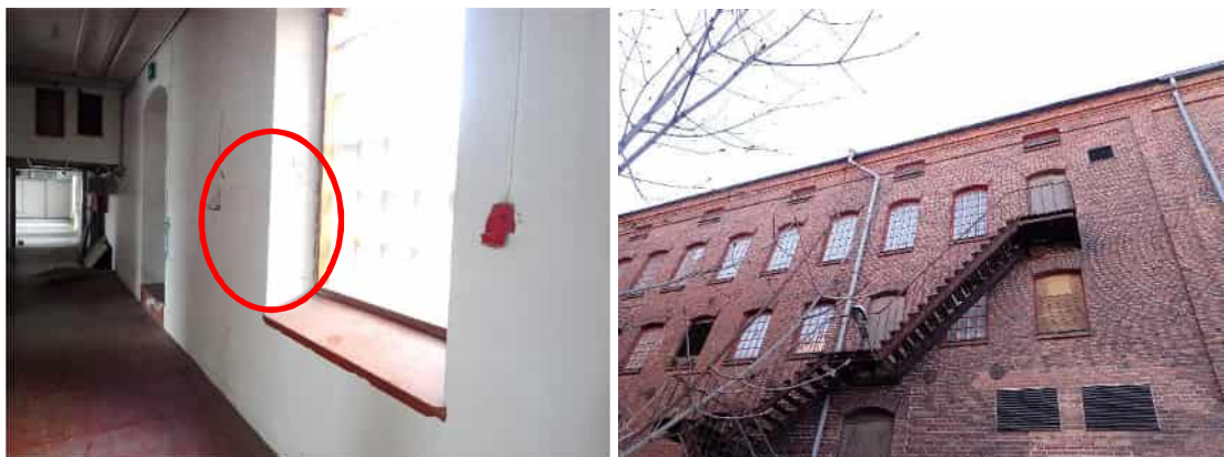
Kuvat 23 ja 24. Ulkoseinällä olevien portaiden kiinnitys on kastellut seinärakennetta.
