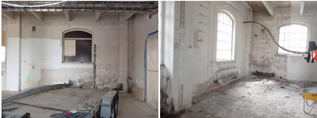
Kuvat 5 ja 6. Maanvastaisten seinien tai osittain maanvastaisten seinien tasoitepinnat olivat laajasti irti ja seinissä todettiin koholla olevia pintakosteusilmaisimen arvoja.
