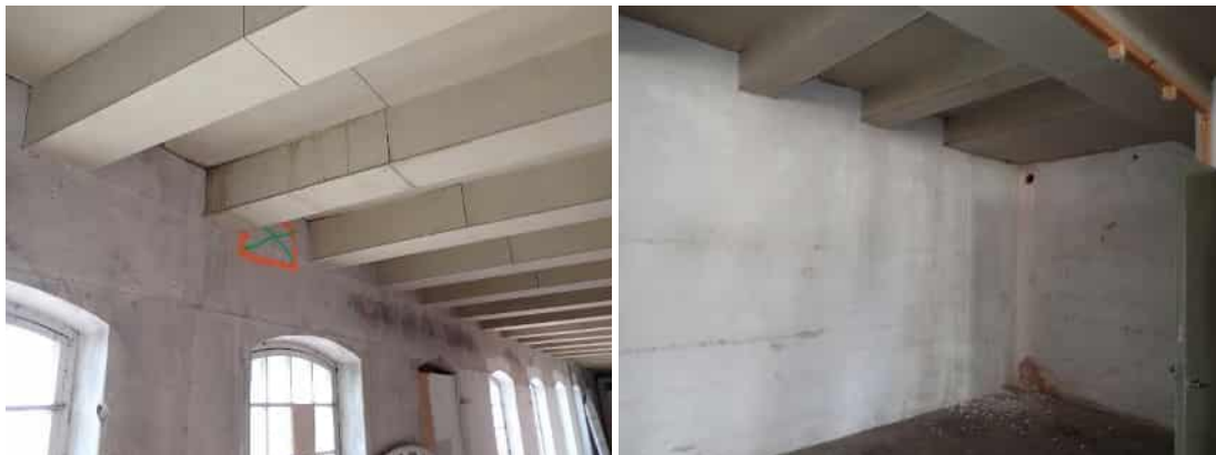
Kuvat 27 ja 28. F3-osan kolmannen kerroksen ulkoseinän ja levytetyn katon vuotojälkiä.
