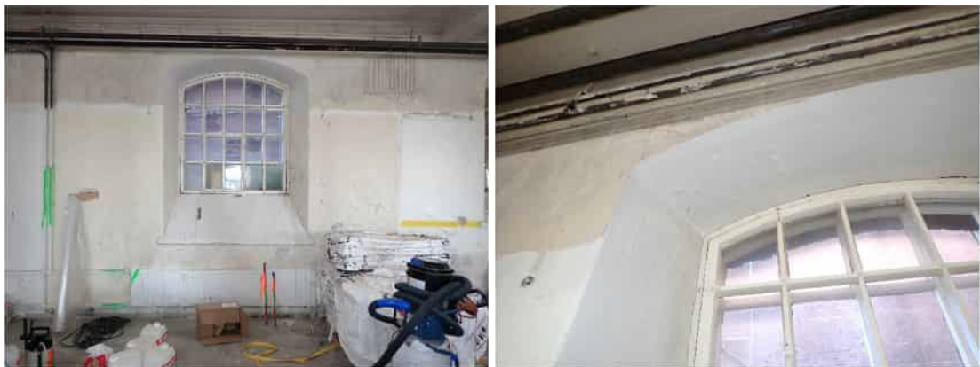
Kuvat 7 ja 8. Maanvastaisten seinien kohdalla koholla olevia pintakosteusilmaisimen arvoja ja tasoitteiden irtoamista todettiin paikoitellen jopa ikkunan yläpielen korkeudella.
