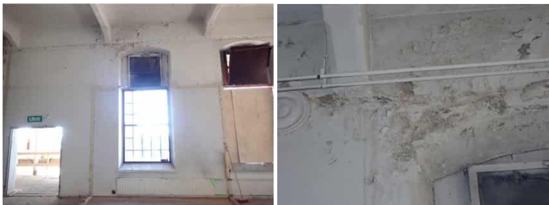
Kuvat 25 ja 26. F4-osan toisen kerroksen ulkoseinän vanha kosteusvaurio todennäköisesti aiemmin vuotaneen syöksytorven kohdalla.
