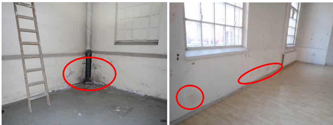
Kuvat 29 ja 30. Näkyvää mikrobikasvustoa seinäpinnalla ensimmäisessä kerroksessa osassa F22 ja F12.
