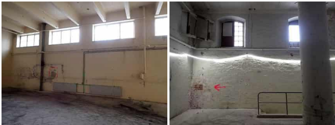
Kuvat 16 ja 17. Ulkoseinän viereisen vesikaton aiheuttamia kosteusvaurioita toisessa kerroksessa osissa F21 ja F5.
