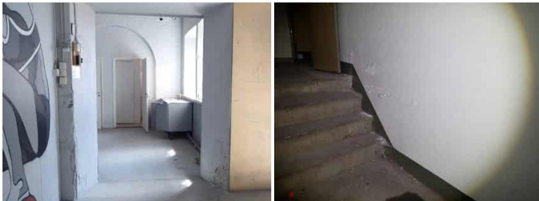
Kuvat 9 ja 10. Kosteusjälkiä seinien alaosissa ensimmäisessä kerroksessa. Rakenteiden kosteudet olivat näkyviä jälkiä laajemmin koholla.
