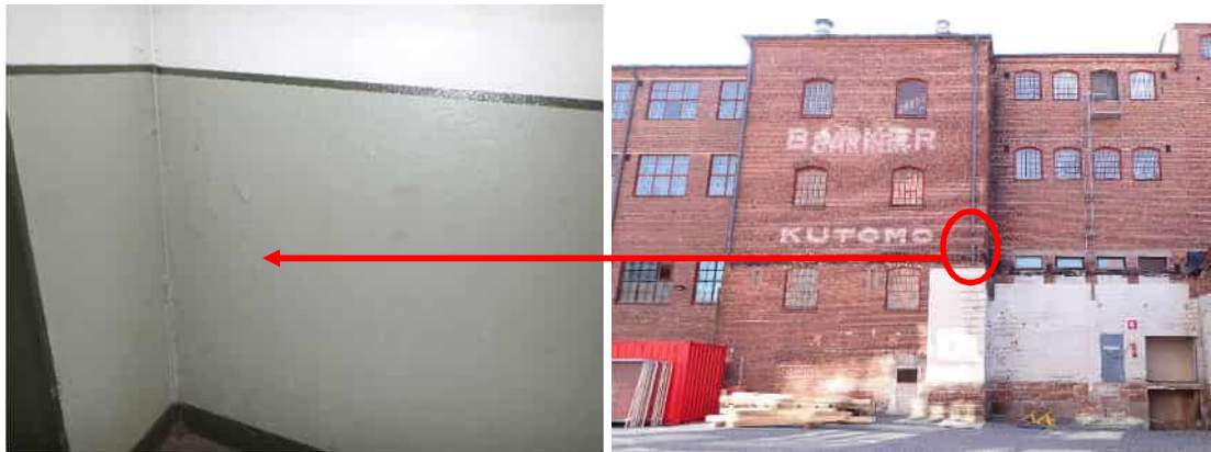
Kuvat 21 ja 22. Porrashuoneen ulkoseinä on kastunut kohdasta, jossa ulkopuolella on seinän keskelle päättävä syöksytorvi.
