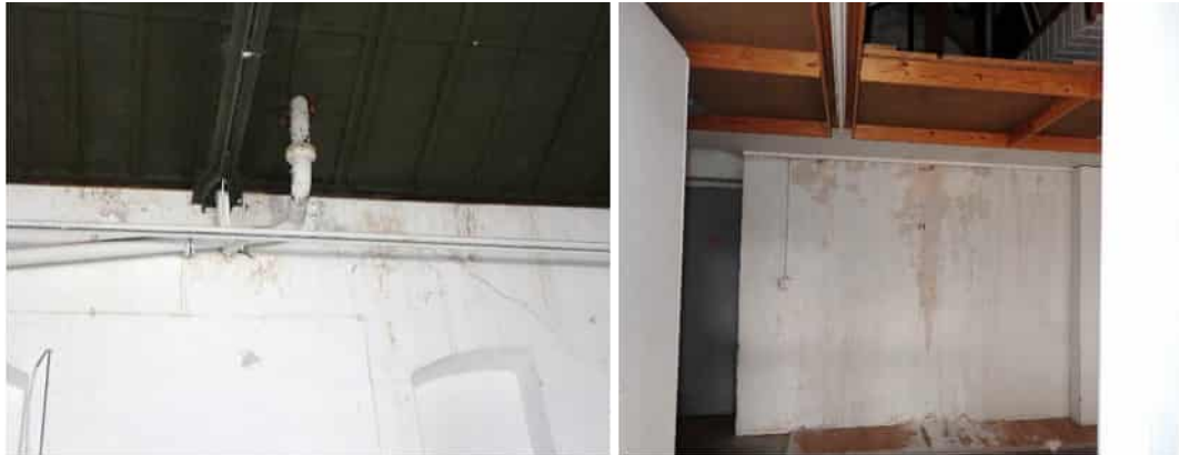
Kuvat 14 ja 15. Kosteusjälkiä osassa F4, jossa takana olevien osien vesikatot kallistavat seinälle sekä osan F6 liittymä osaan F4.
