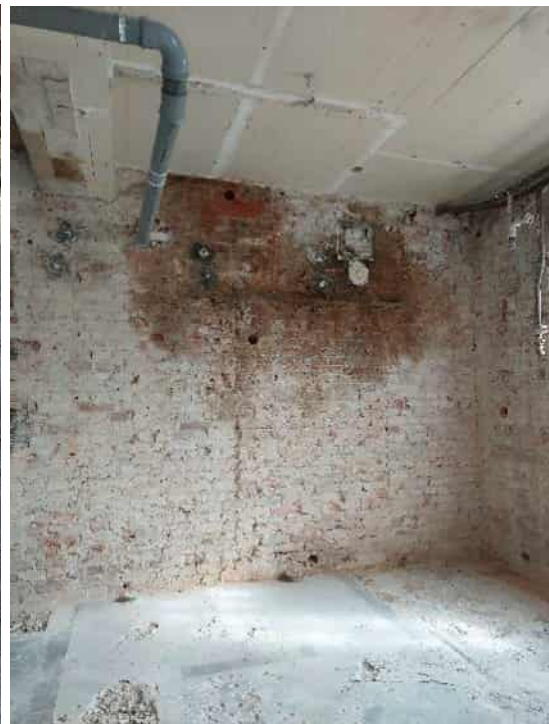
Kuva 3. Lohkon F3 ja F4 välisessä seinässä havaittiin selkeitä tummia jälkiä, voimakasta öljynhajua ja näytteillä todennettuja korkeita öljyhiilivetypitoisuuksia läpi rakenteen.
