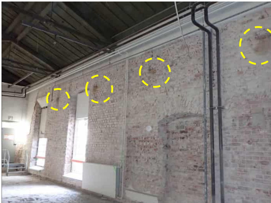
Kuva 8. Lohkon F4 ylimmän kerroksen joenpuoleisella seinällä on useita öljyisiä jälkiä.
