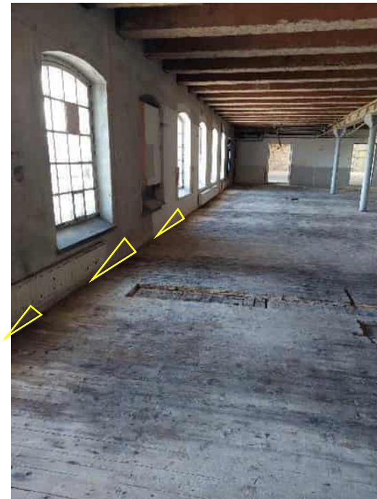
Kuva 2. Tummia jälkiä pilaavasta toiminnasta lohkoissa F3, 4. kerroksessa. Vastavilla kohdilla olevia tummia jälkiä oli havaittavissa myös seinissä (korostettu keltaisella).
