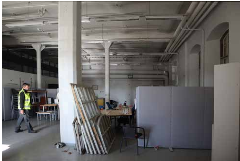
1. kerros on korkeaa yhtenäistä tilaa. Kaikki ikkunat on ummistettu levyillä.
