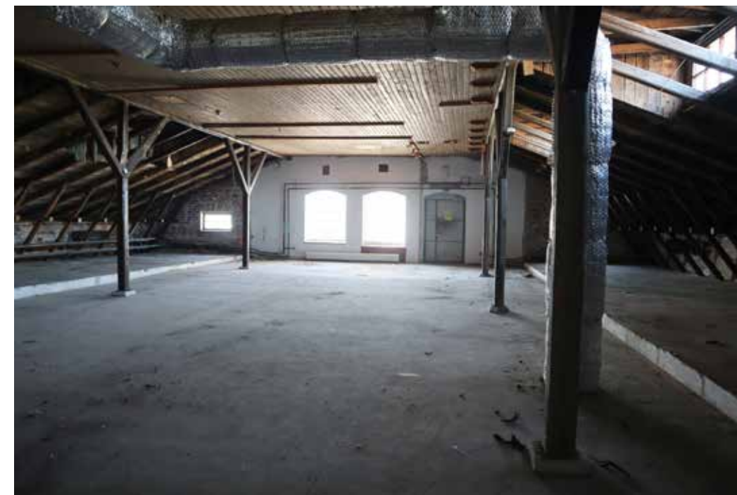
Keskiosassa säilytetyn alakaton yläpuolella kulkee ilmastointikanavia.
