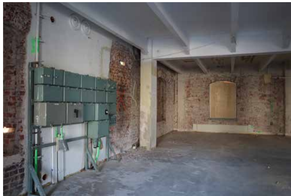
F3 tilan vastaisella seinällä on säilynyt vanhoja sähkökaappeja.
