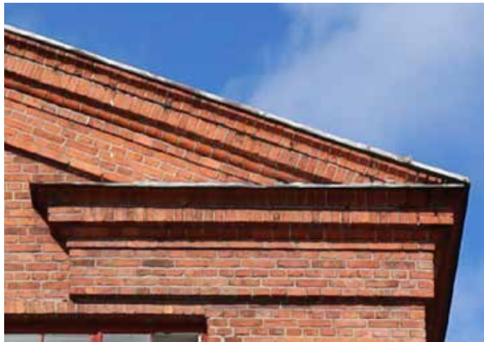
F6-osan muurattu räystäs.
