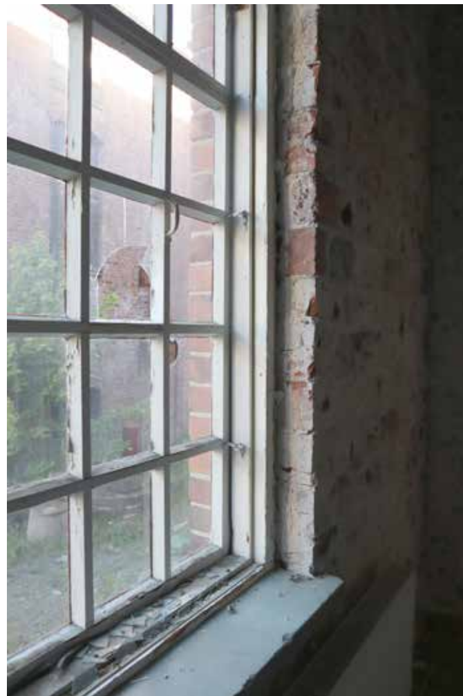
Ikkunaruutu on kiinnitetty hakasilla, ilman saranaa. Lasi on rikkoontunut ja sisempi ikkunapuite puuttuu.
