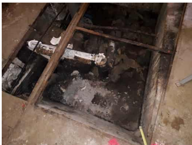
Kuva 6. Öljyinen pohjabetonilaatta näkyvissä.
