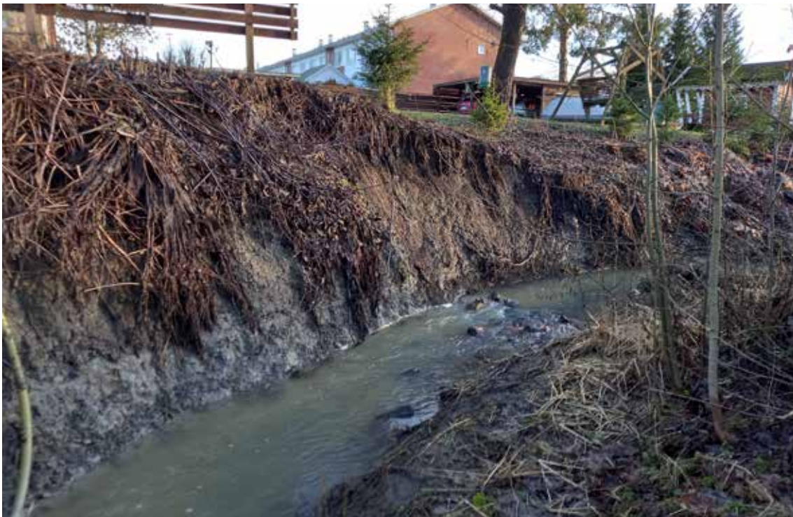
Kuva 22. Topinojan itäosaa. Ojan törmät olivat monin paikoin romahdelleet. Luoteesta / 26.1.2023 / J. Leppänen (MuTu122006Dg_11)
