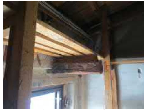
Kuva 6.14 Keskimmäisen varaston ikkunan yläpuolella oleva tukipuu nostokoukkuun varten
