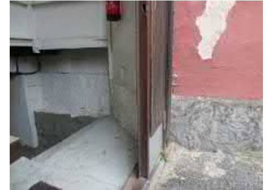
Kuva 3.28 Liike 32: Sisäpihan puoleinen sisäänkäynti. Portaat kellarisiin suojattu seinin. Suojaseinän rakennusvuosi ei tiedossa.
