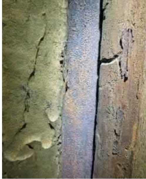
Kuva 4.62 Vesikaton vanhojen lautojen välissä näkyvissä v. 1871 palovakuutuksessa mainittua rautapeltikatetta.
