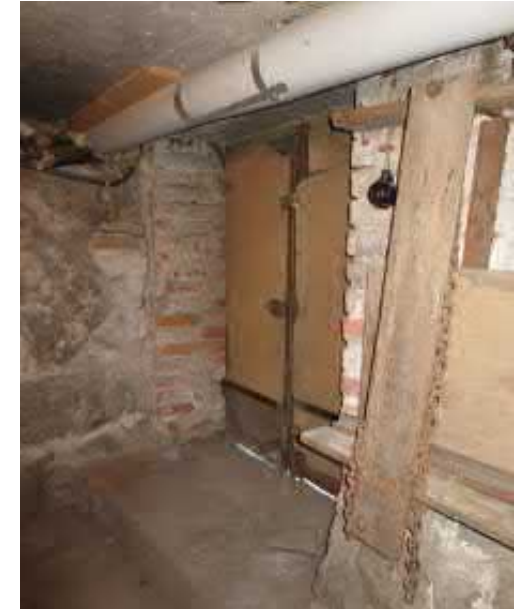
Kuva 3.20 Kellari/liike 29: kellarin ulko-ovi
