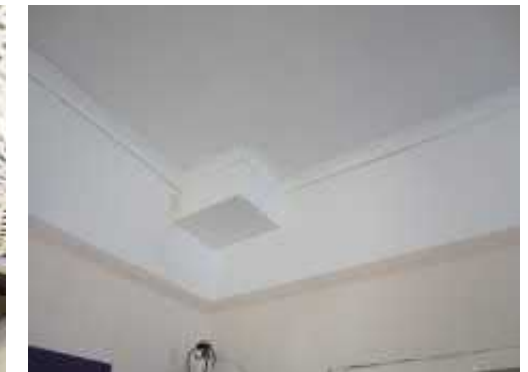
Kuva 3.82 As 34: poistetun tulisijan hormi katkaistu
