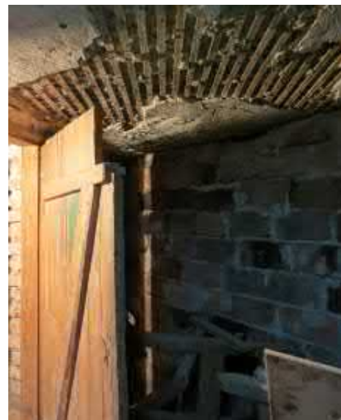
Kuva 3.37 Kellari/liike33: kellarin katon tikku-rappausta
