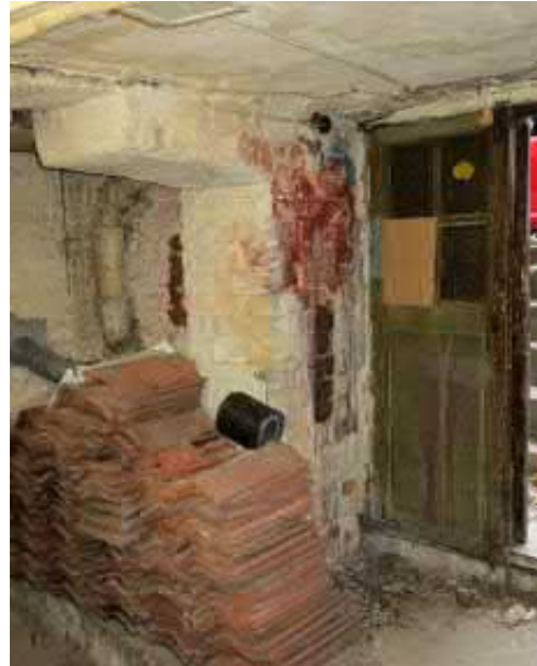
Kuva 3.24 Kellari/liike 30: kellarin ulko-ovi
