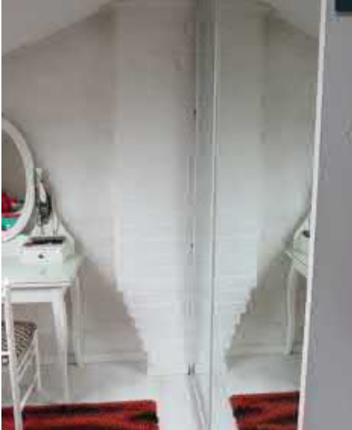
Kuva 3.108 Asunto 24: vanha hormi päätyseinällä
