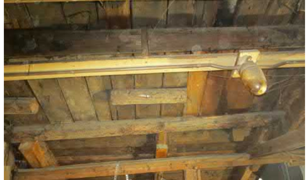
Kuva 4.59 Vanha vesikaton laudoitus
