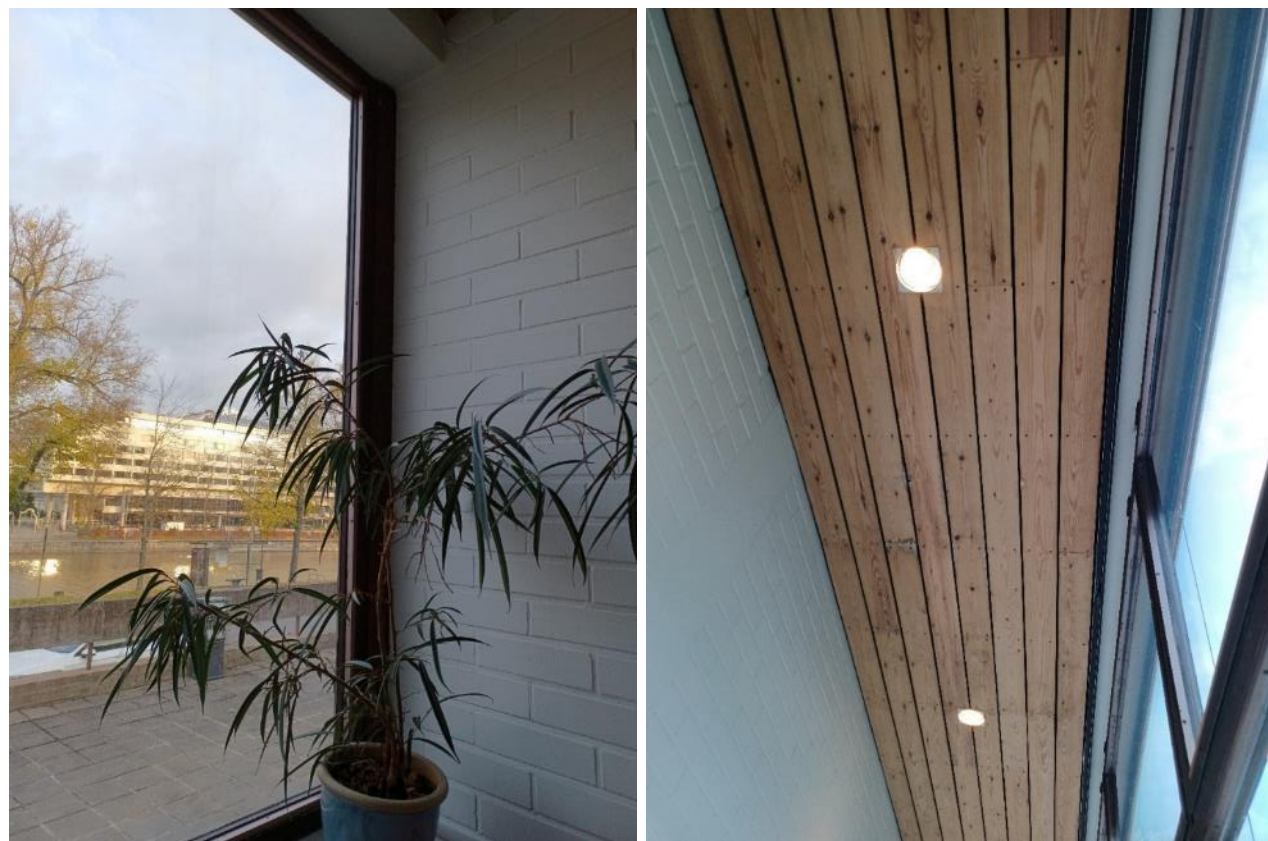
Kuva 115. (vasemmalla) Näkymä toimistihuoneen suuresta ikkunasta kohti Aurajokea. (oikealla) Toimistuhuoneen puupaneloinnissa näkyi paikoitellen vanhoja vesivaurioita, jotka lienevät kattovuodoista peräisin.
