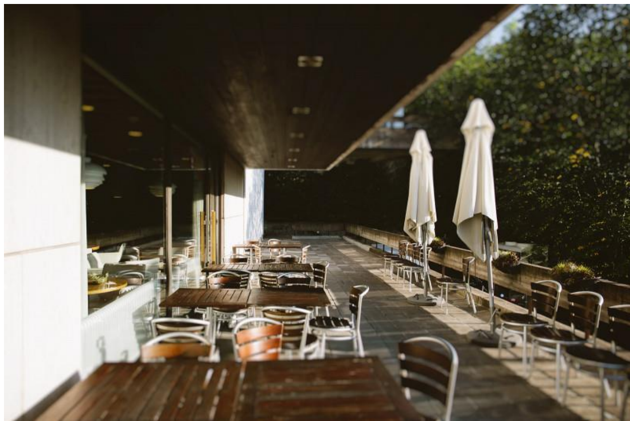
Kuva 121. Café Wäinön terassi. Betonilaatat ovat päässet huoonon kuntoon veden lätäköitymisen ja routimisen vaikutuksesta. Kahvilatilassa näkyvät valaisimet ovat alkuperäiset. (Kuvälähde: WAMin.internetsivut. )
