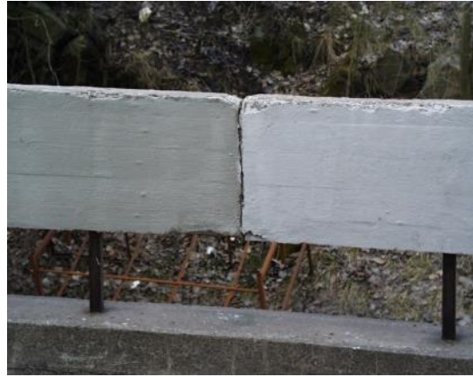
Kuva 39. Kuva betonikaiteesta vuodelta 2000, ennen korjaustöitä. (Turun kaupunkiympäristön arkisto)
