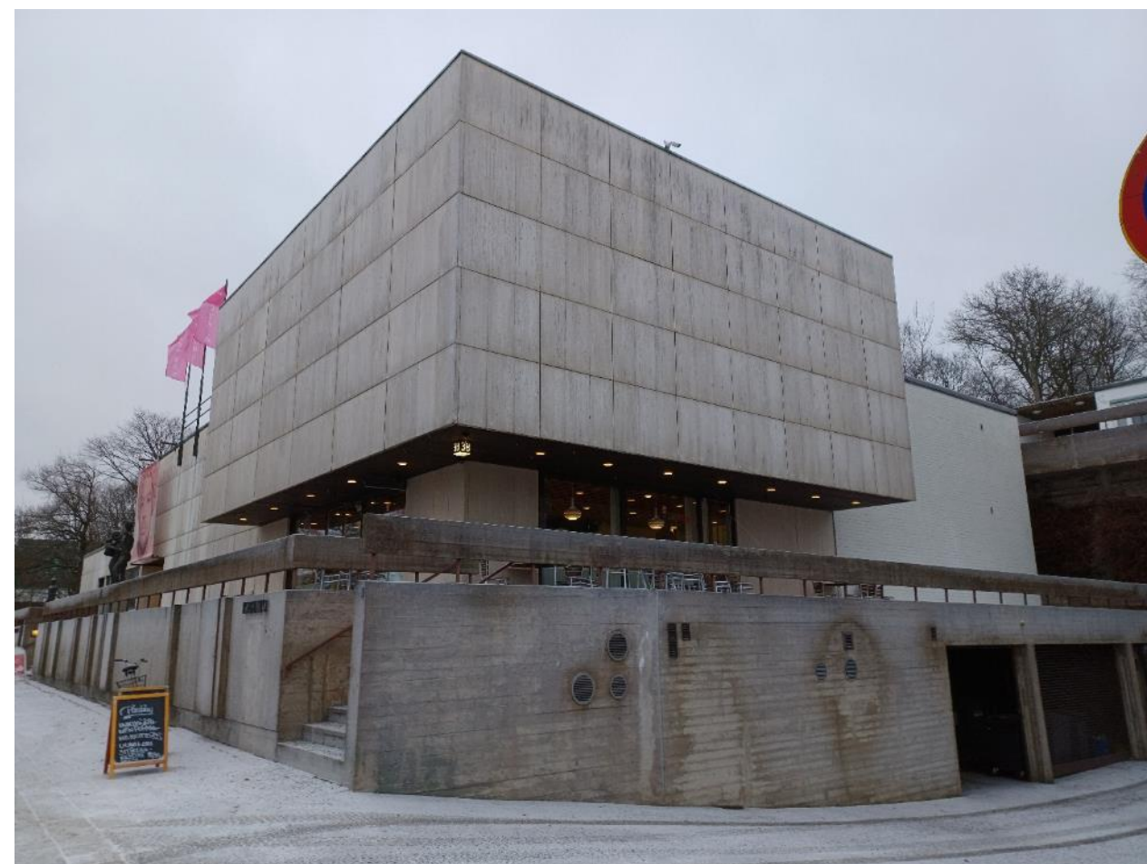
Kuva 53. Rakennuksen pintamateriaalit ovat alkuperäisiä tai alkuperäisen kaltaisia. Ulkopinnat, lähinnä travertiinivuoraus, betonimuuri sekä kaide ovat kärsineet sääolosuhteiden vaihtelusta ja ilmansaasteista. Kuvanottohetkellä muurin pinta oli osittain jäässä.
